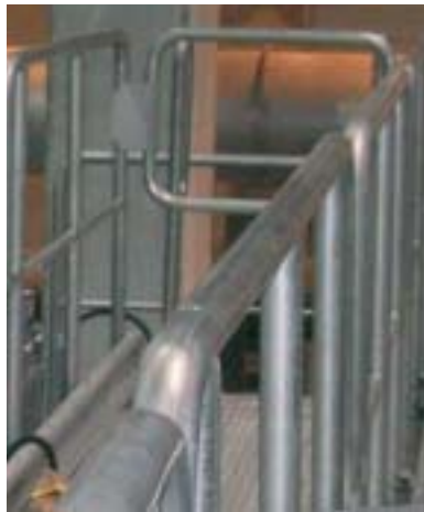
Diese Durchgangssperre vor der als Notabstieg dienenden Steigleiter am Ende eines Papiermaschinenlaufsteiges entspricht den Vorgaben der Norm.
