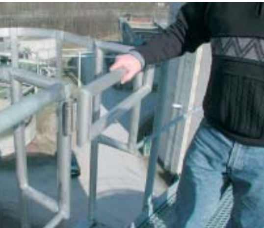
Steigleiter als Notabstieg an einem Behälter der Kläranlage. Absturzsicherung durch Rückenschutz und Durchgangssperre, die leider nicht der Norm entspricht.
