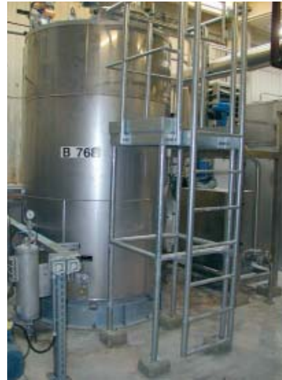
Steigleiter als Zugang für Inspektionszwecke zu einem Behälter. Da die Höhe kleiner 3 Meter ist, ist keine Absturz- sicherung erforderlich. Die Durchgangssperre entspricht nicht der Norm, da die Knieleiste zu hoch angebracht ist.
