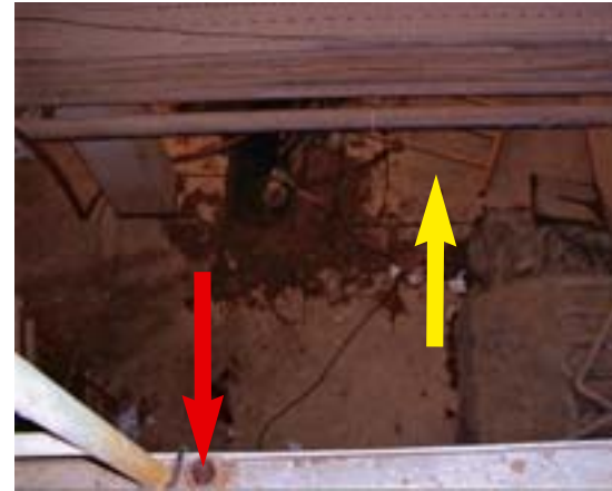
Absturzstelle, der gelbe Pfeil weist auf das abgebrochene, in die Tiefe gefallene Geländerelement. Der rote Pfeil weist auf die Steckmuffe.
