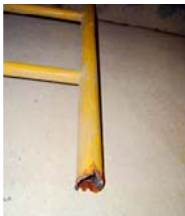
Bruchstelle am Geländerpfosten
