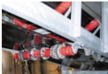
Bild 5: Auflaufstellen an den Tragwalzen des rücklaufenden und vorlaufenden Trum eines Bandförderers für Rejekt. Auch diese Gefahrstellen müssen bei Einzuggefahr gesichert werden.
