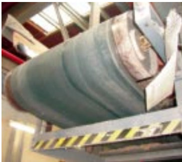
Bild 6: Diese Auflaufstelle an der Umlenkwalze eines Gurtbandförderers ist ungesichert, da die montierte Schutzrichtung nicht stabil genug ist.
