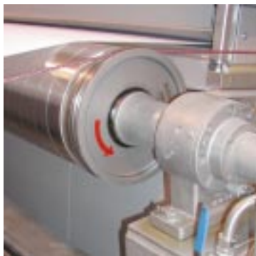
Papierleitwalze mit Markierung auf der Seilscheibe. Achtung: Aus dem Stillstand der Markierung kann nicht auf den Stillstand der Leitwalze geschlossen werden!
