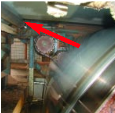
Beispiel: Auflaufstelle (Pfeil)
