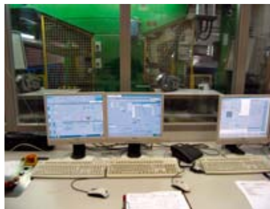
Gerüstet für die nächsten Jahre: Modernisierter Rollenschneider
