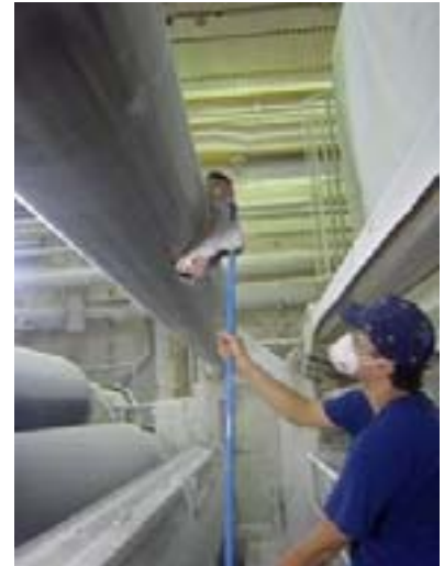
Mit Hilfe der im Bild gezeigten Vorrichtung ist das Reinigen gefahrlos möglich
