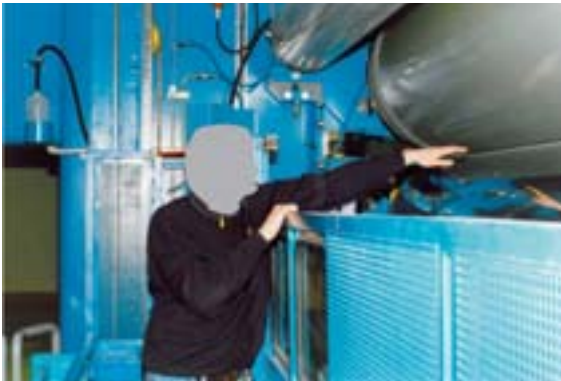
Die Praxis: schützende Konstruktion an einem Kalandr. Das Erreichen der Einzugsstelle (hohes Risiko) wird durch ein Schutzgitter verhindert.
