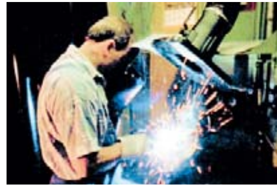
Beim Schweißen entsteht gesundheitsgefährdender Rauch. Dieser Schweißrauch kann z. B. über eine Düse oder über eine Absaughaube erfasst und gefiltert werden. Quelle: BGI 593
