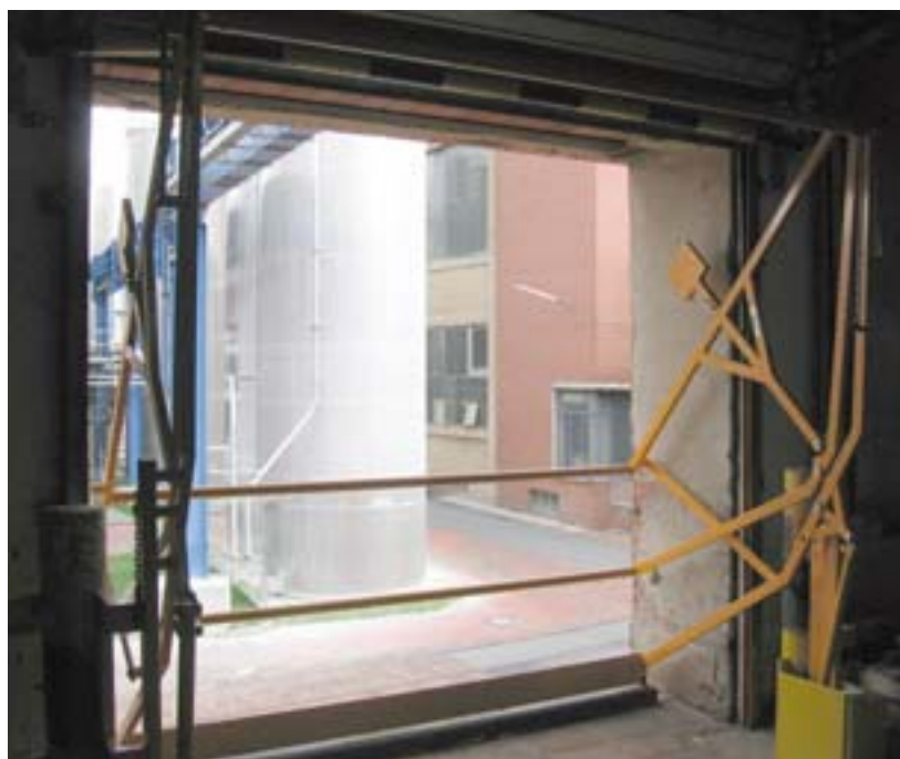
Bild 3: Durch Schleusengeländer gesicherte Ladeluke. In der gezeigten Stellung ist auch bei geöffnetem Tor der Absturz von Personen und Ladegut weitgehend verhindert.
