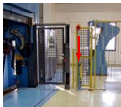
Links die Zugangstüre, rechts daneben die Rollenschleuse. Dazwischen die Zweistrahl-Lichtschranke (Pfeil).
