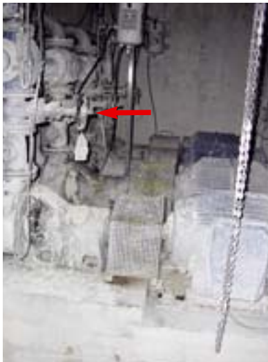
Der Strom floss vom Handrad (Pfeil) über den Körper zum nassen Boden.
