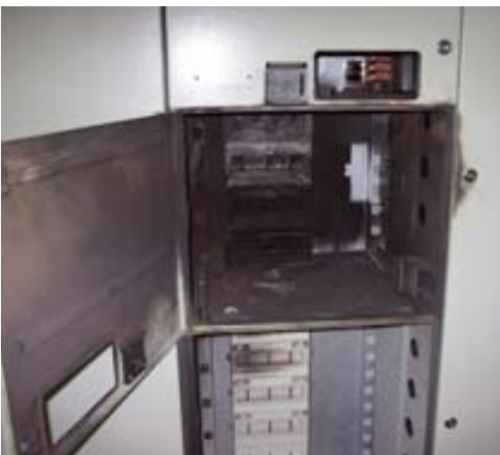
Der ausgebrannte Schaltschrank (ohne Einschub)
