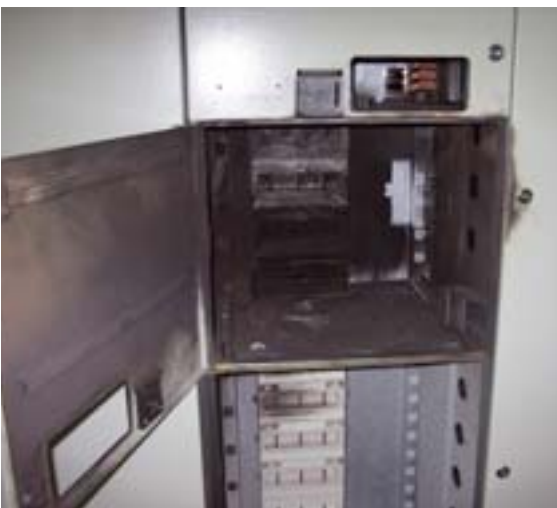
Der ausgebrannte Schaltschrank (ohne Einschub)
