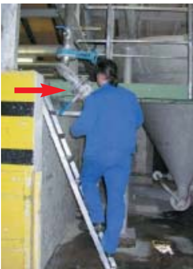
Nachgestellte Situation Pfeil: Die zu reinigende Rohrleitung
