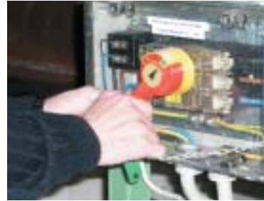
Bild 4: Hauptschalter eines Holländers mit NOT-AUS-Funktion
